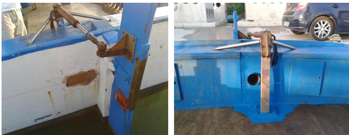
Εικόνα 9: Φωτογραφίες όπου απεικονίζεται η τροποποίηση στον μηχανισμό πηδαλιού για την αποφυγή παρόμοιων καταστάσεων
